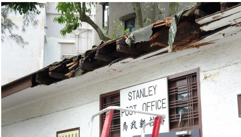
郵局正面的木製桁樑有約4米長明顯裂痕。
