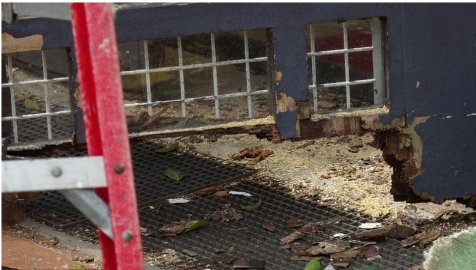
正門鐵閘底部有輕微損毀。
