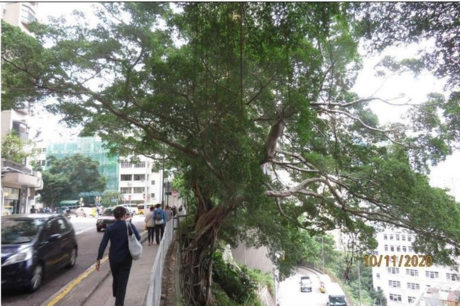
路政署指古樹不斷從石牆向醫院路傾斜，有倒塌風險。路政署報告截圖
